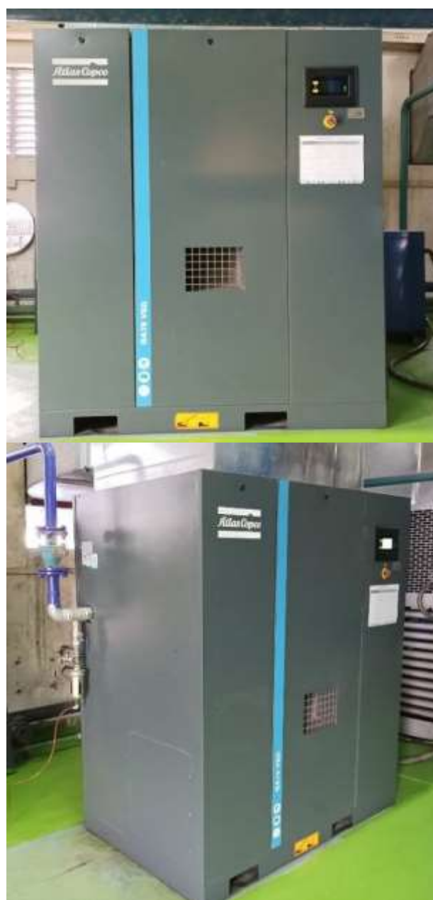
4 台 75kW 永磁電機及變頻功能的節能螺桿空氣壓縮機
